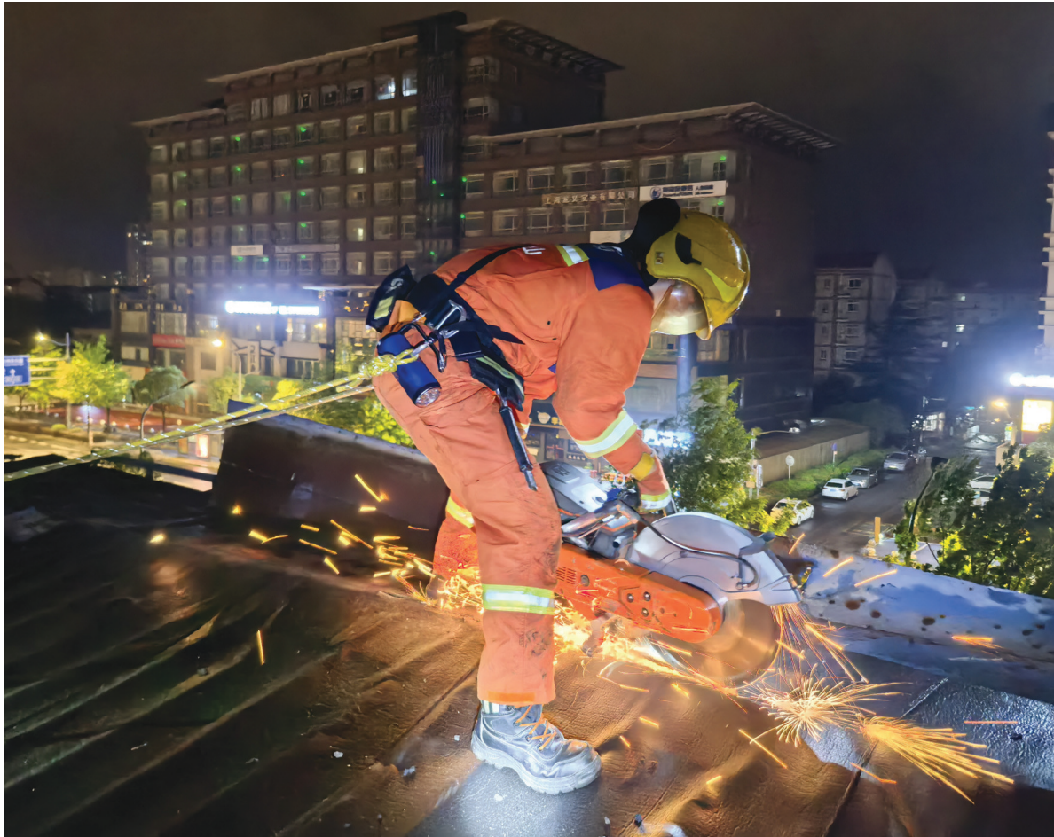
应急人员在楼顶处置险情。
