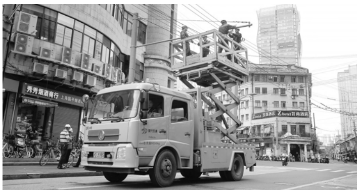
线网维护人员在作业。
