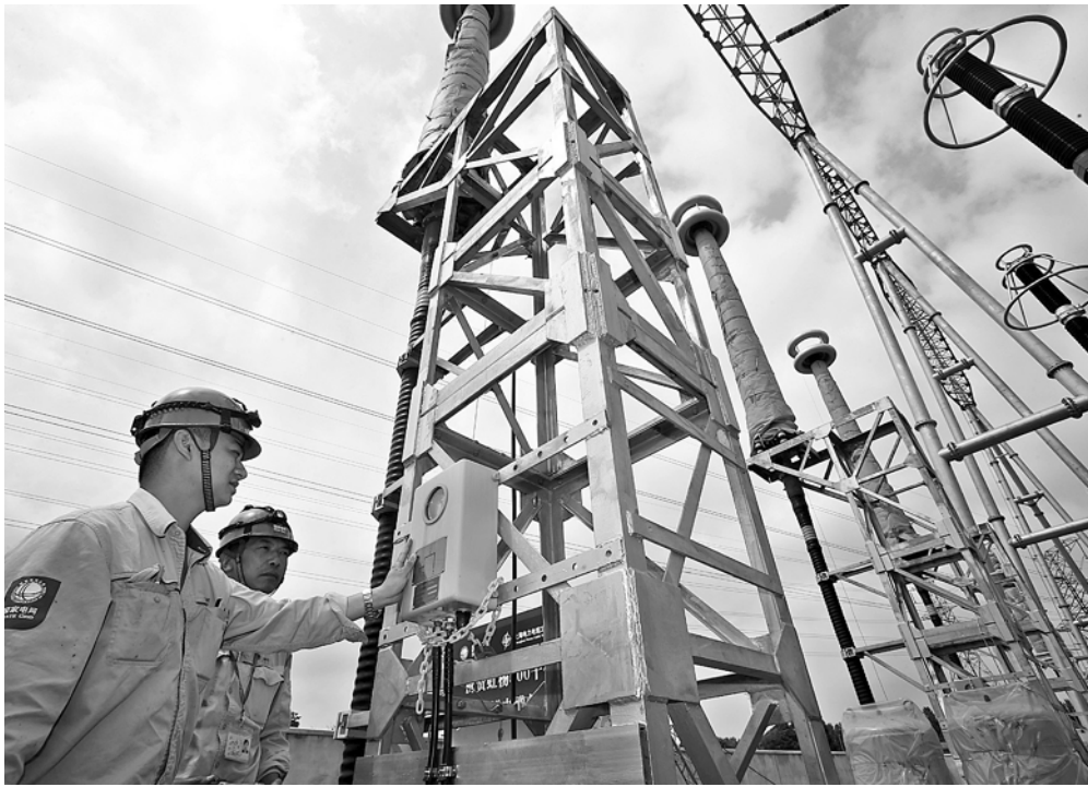
工作人员在检查设备。
