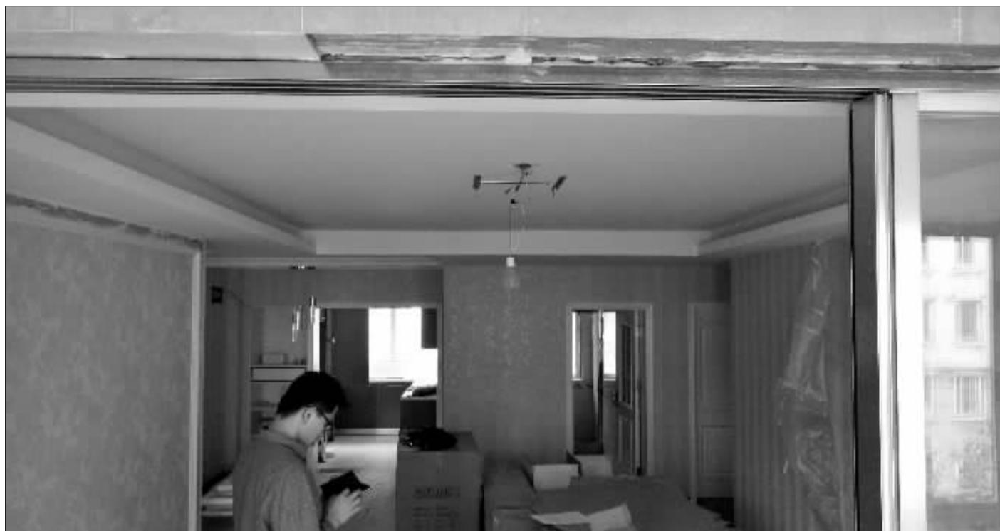
在装修公司承诺的竣工期一个月后,灯具还是没有安装上。
