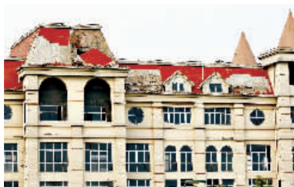
有些商铺年久失修。
