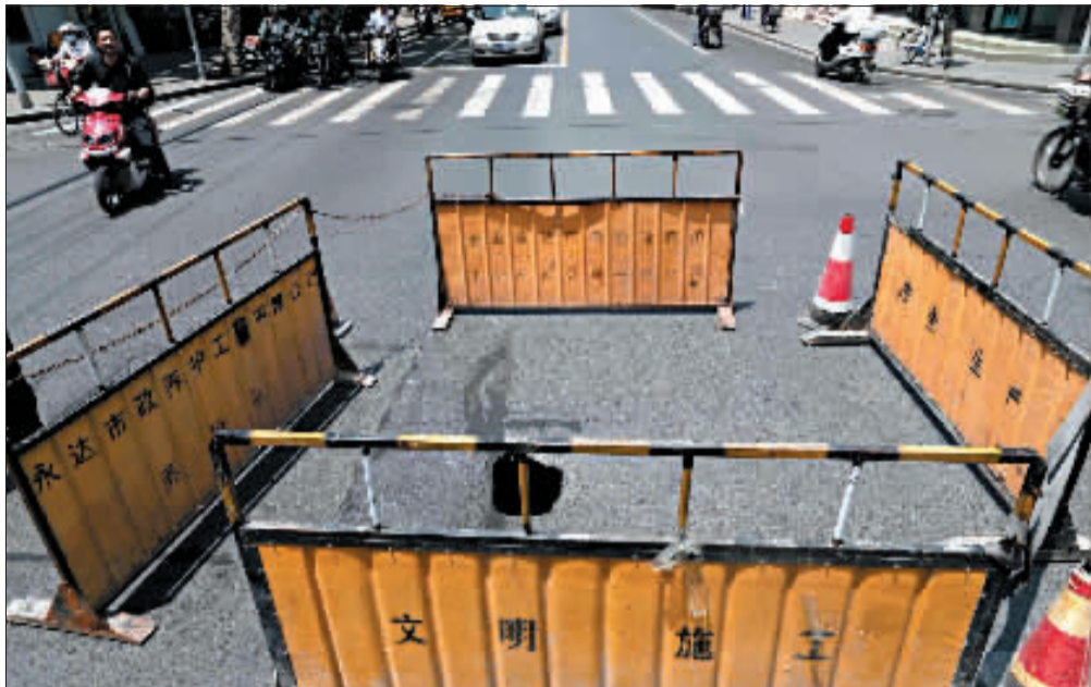
遵义路玉屏路口路面塌陷“黑洞”直径约半米，有关部门竖起警示装置提醒来往路人车辆。本报记者 张瑞麒 摄
