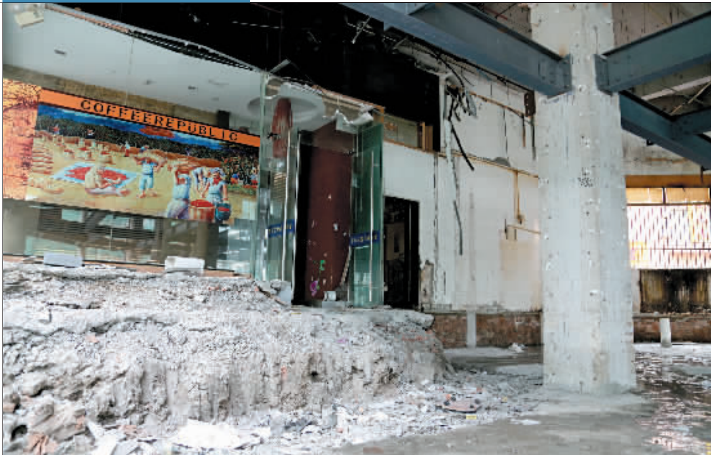
商铺违规装修,居民很害怕。
