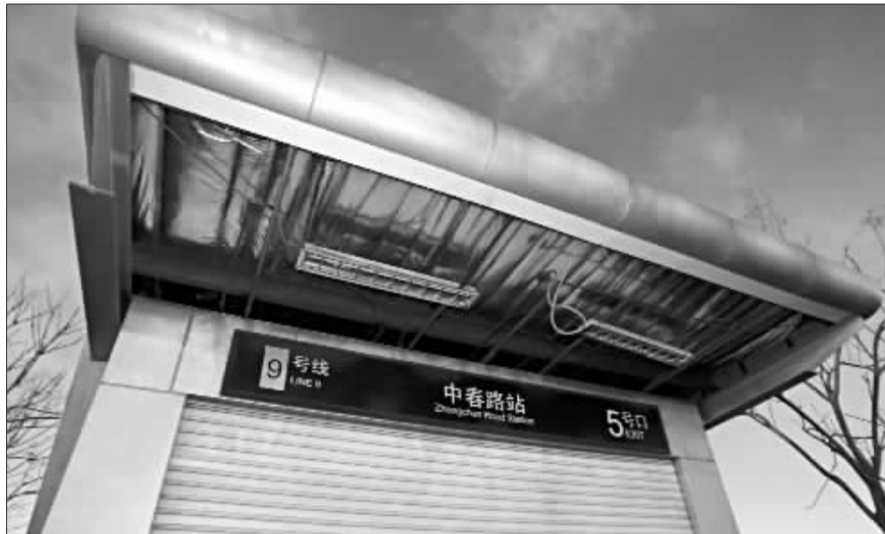
9号线中春路站部分关闭的出入口遭破坏。
