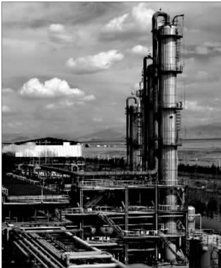
报告中提到，显著减少主要污染物排放总量”引人关注。图为青海格尔木炼油厂30万吨天然气制甲醇生产装置，它实现了二氧化碳回收补碳和释放气回收重燃。
