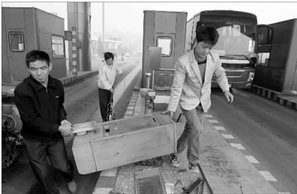
10月8日零时起,郑州黄河公路大桥终止收取通行费。目前,收费站内的收费设施已开始拆除,这标志着作为河南省第一条收费桥梁——郑州黄河公路大桥结束了26年的收费历史,正式回归公益。 新华社图
