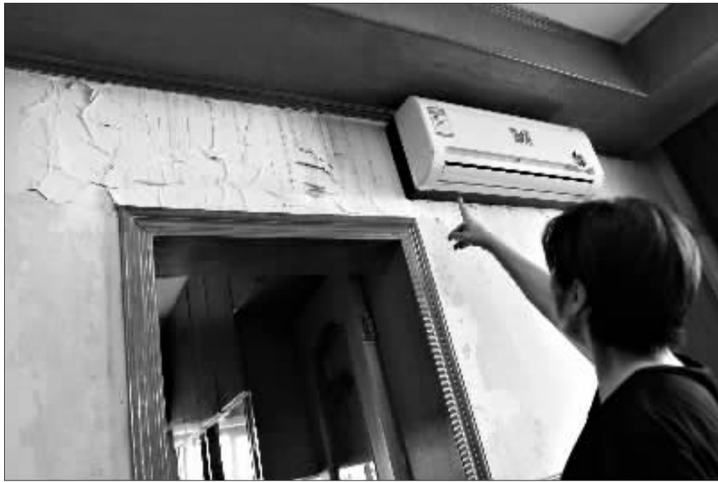
居民家墙壁被水浸泡,空调也进水了。
