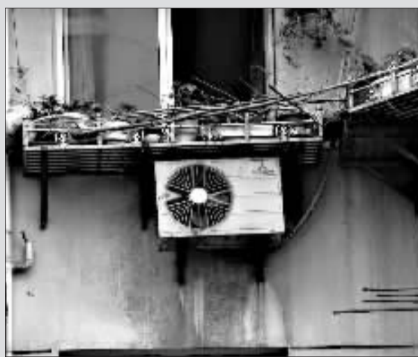
彭浦周边小区的空调支架锈迹斑斑。 本报记者 杨磊 摄 ◀空调支架有望迎来具有强制性的标准。 本报记者 张瑞麒 摄
